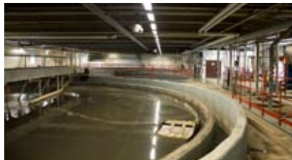
Försedimenteringsbassäng i centrala reningsverket.
