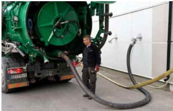
Tömning av slambil till reningsverket.
