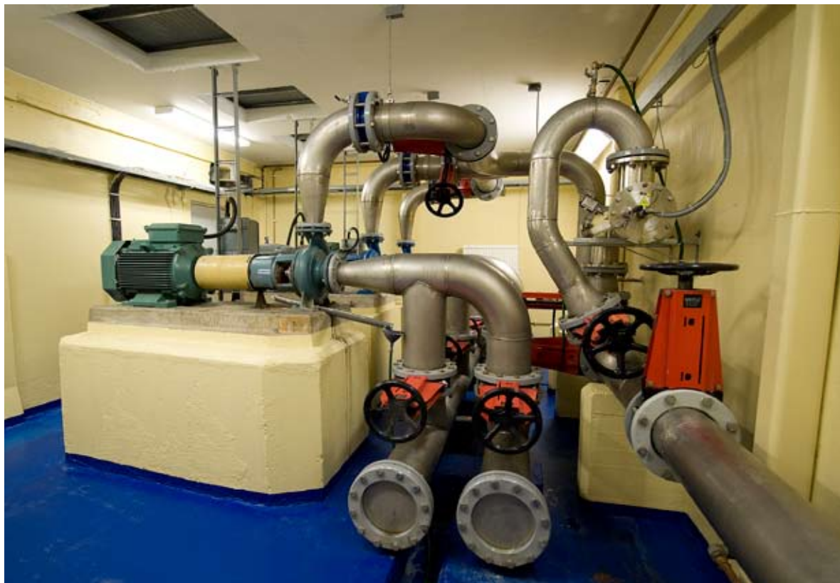
Kraftiga pumpar leder vattnet ut på nätet.
