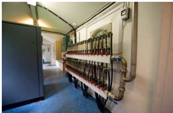
Fördelningsrör för luftning av grundvattnet. Anledning till luftningen är att minska utfällning av mangan i ledningsnätet.
