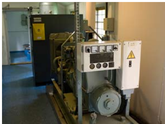
Elverk för råvatten.
