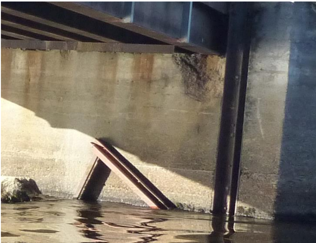
Figur 8 Norra landfästets upplag skadat vid yttrebalk.
