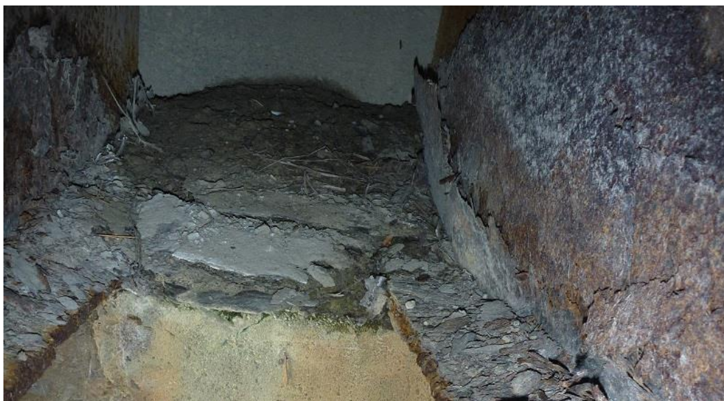
Figur 5 Stålbalkar angripna av gravrost, vy mellan balkar blickande mot landfäste.
