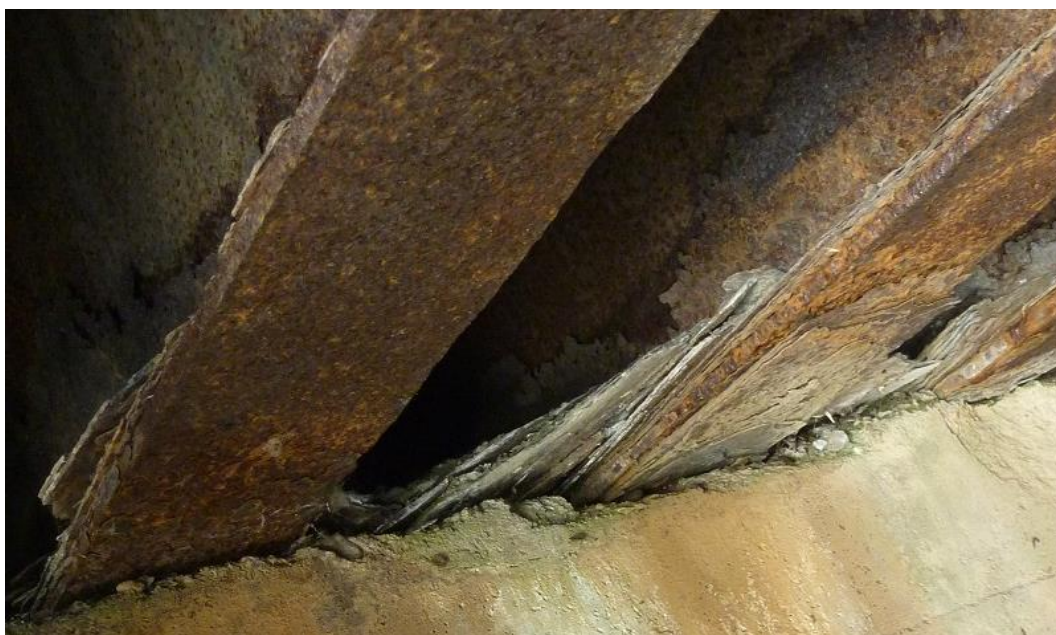
Figur 6 Stålbalkar angripna av gravrost, vy under balkar blickande mot landfäste.
