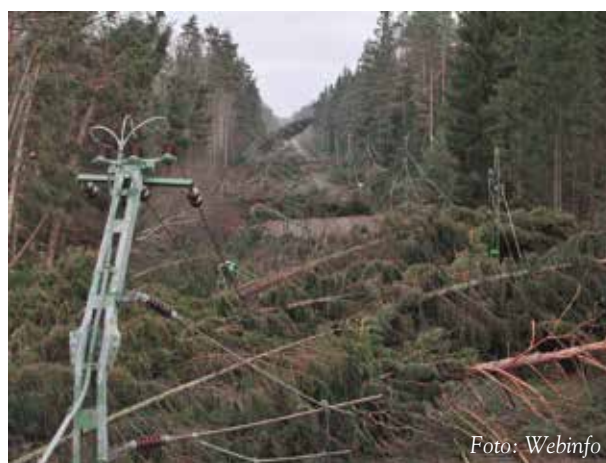
Grov skadegörelse på kraftledningarna i stormens spår
